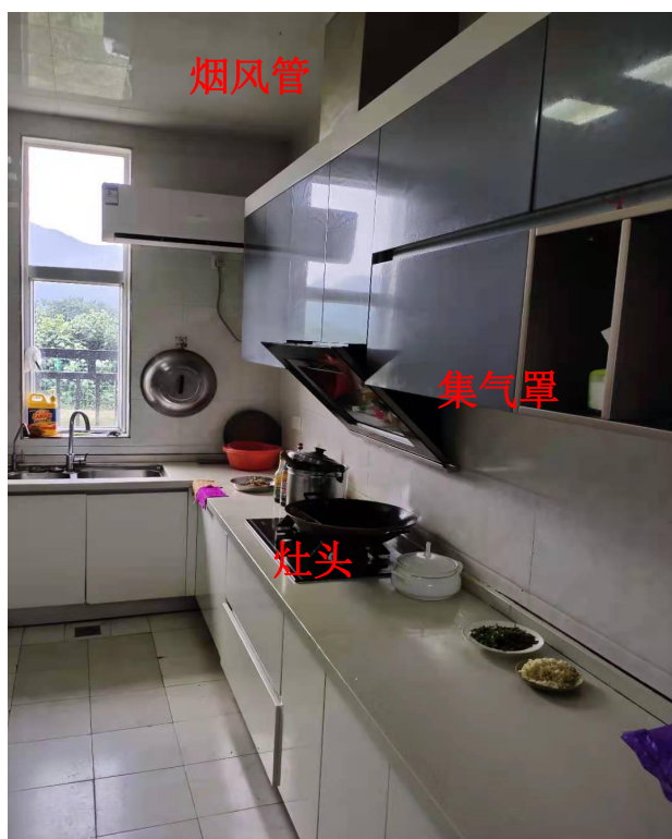
图 7.4-1 厨房集气罩及烟风管（通楼顶）
