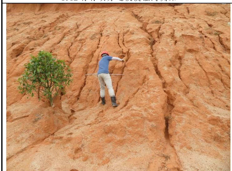
TJ13 标填方边坡侵蚀沟测深
