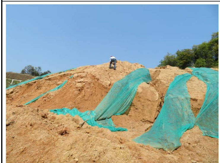
TJ12 标填方边坡侵蚀沟测深
